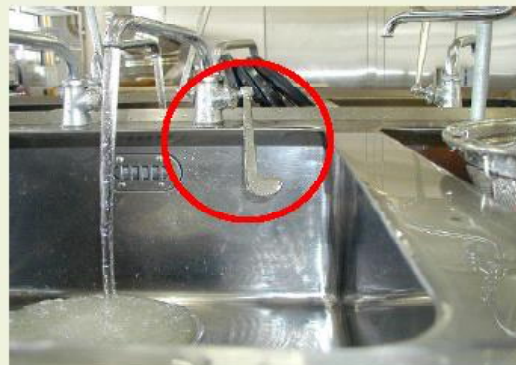
✗ 取り付け角度が悪いレバー式給水栓
