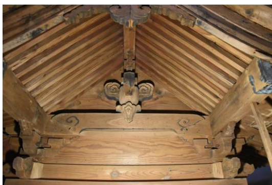
つまめん しゃんした こうりよう たいいづか 妻面（写真下から虹梁、大瓶束）
