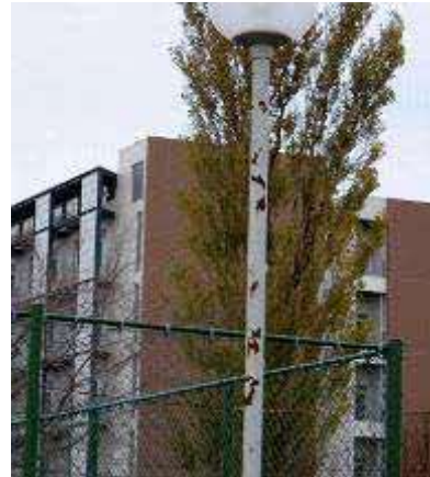
錆が著しい外灯の例
