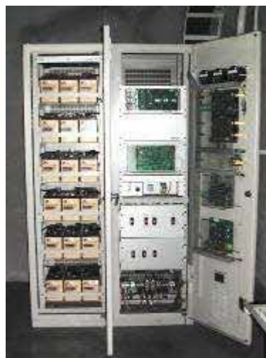
直流電源装置（内部）
