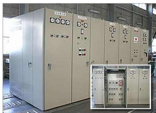
屋内形キュービクル式配電盤
