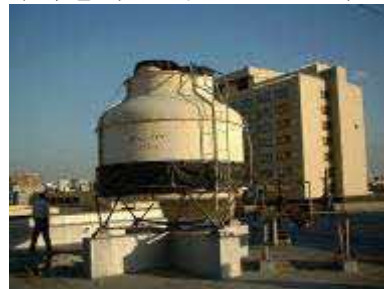
冷却塔（クーリングタワー）の例
