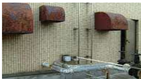
錆の著しいフード・配管の例
