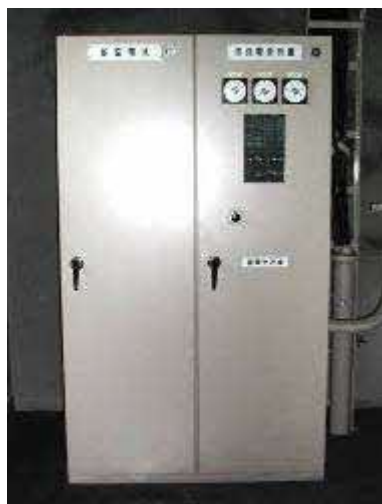
直流電源装置
