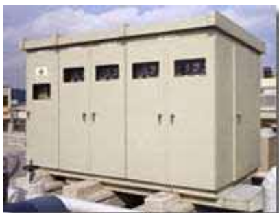
屋外形キュービクル式配電盤
