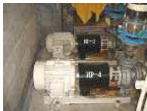
空調用ポンプ
