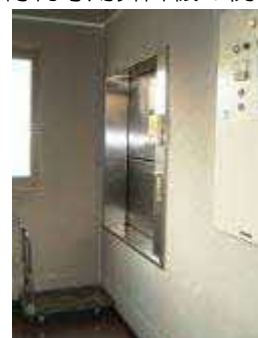
小荷物専用昇降機の例
