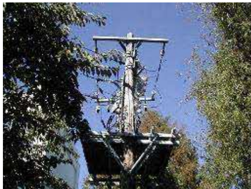
樹木と架空電線の接近例
