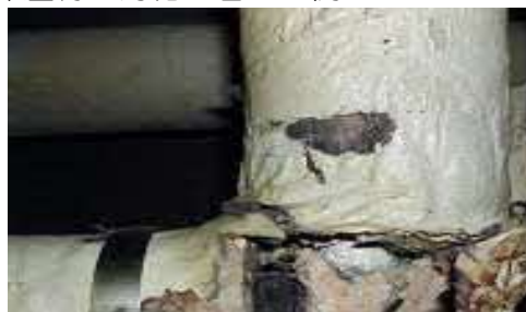
保温材の劣化が著しい例
