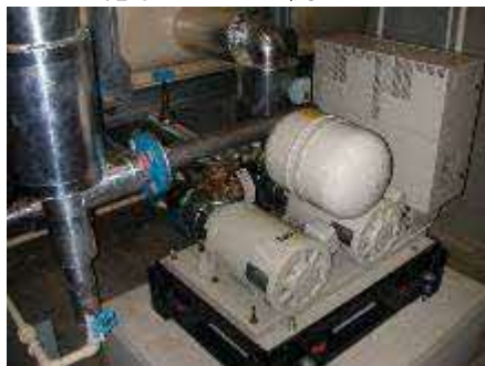
給水ポンプの例
