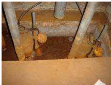
排水ポンプの例
