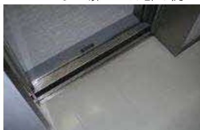
エレベーター扉レール部の例
