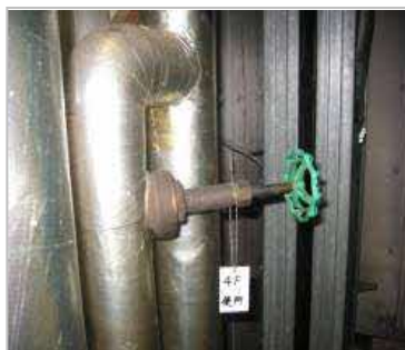
屋内配管の例
