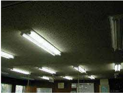
事務室の蛍光灯 (うなり音を発していた例)
