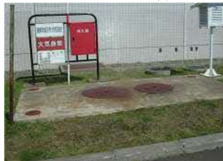
オイルタンクの例
