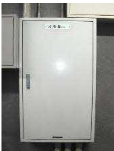
分電盤 異常なし
