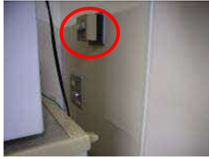
異常あり(放熱機器の側に設置)
