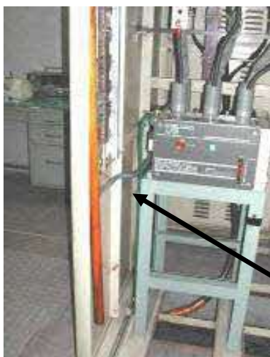
自家発電装置 異常なし
