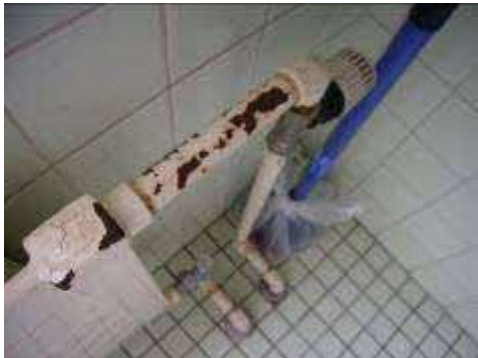
異常あり(露出配管腐食)
