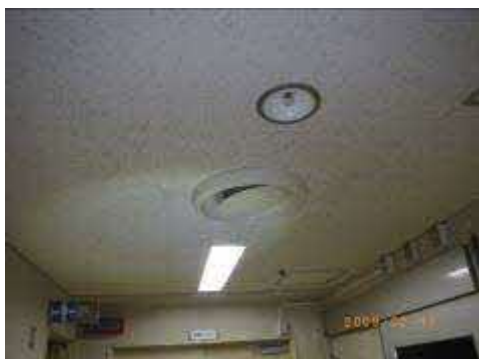
異常あり(吹出口が傾いている)
