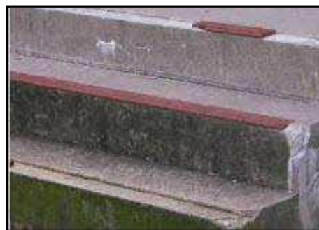
屋外階段等 異常有り (クラック) (滑り止めタイル剥落)
