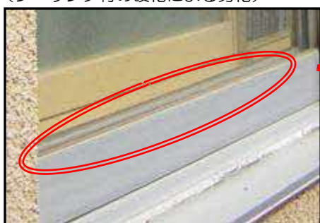
外部建具(ガラス留め) 異常有り (シーリング材の硬化による劣化)
