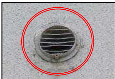
外壁仕上げ材 異常有り (換気口周囲のシーリング材の劣化)
