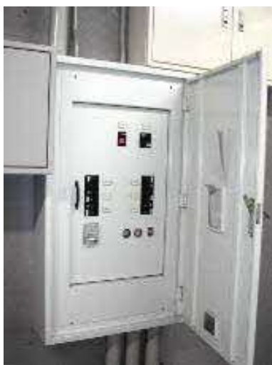
分電盤 異常なし
