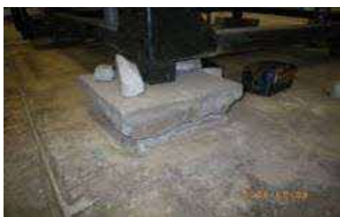
異常あり（基礎が破損している）
