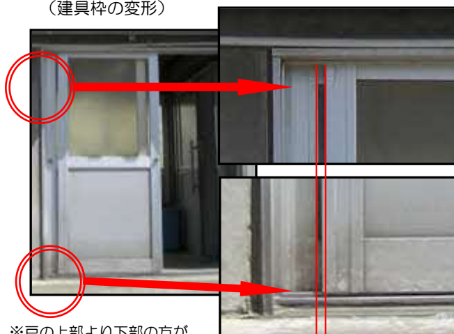
外部建具 異常有り (建具枠の変形)
