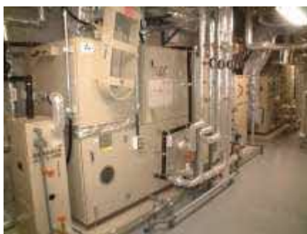
ユニット型空調機
