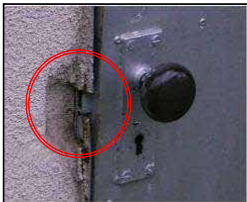
外部建具 異常有り (枠の腐食、施錠不可)
