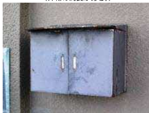
分電盤 異常あり （外箱の腐食がある。）
