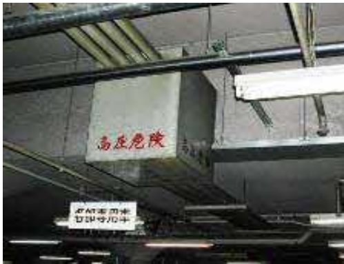
高圧ケーブル類（ボックス） 異常なし （一部腐食している。）
