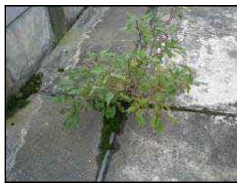
屋上面 異常有り (雑草全面に繁茂)
