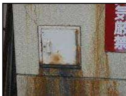
外部点検口 異常有り (著しい錆、開閉不能)
