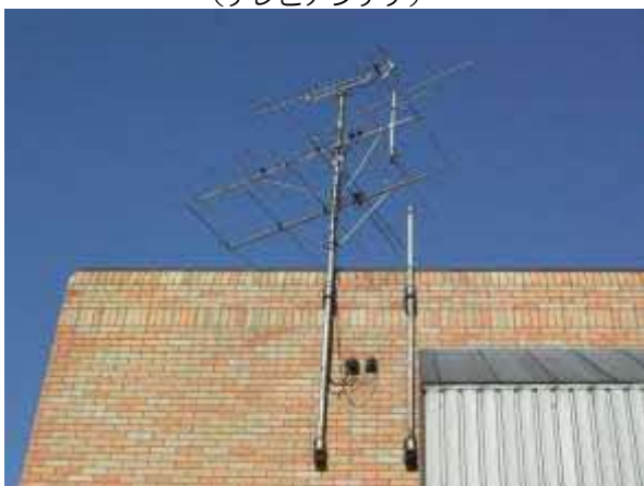
テレビ共同受信設備 異常なし （テレビアンテナ）
