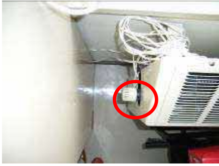
異常あり(熱の循環しない場所に設置)
