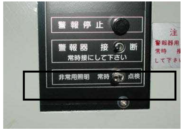
切替装置1 試験用スイッチの例
