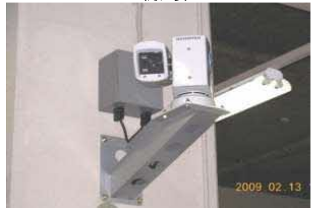
監視カメラ設備 異常なし （カメラ）
