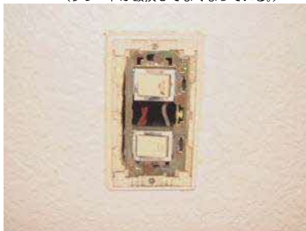
スイッチ 異常あり (プレートが破損してなくなっている。)
