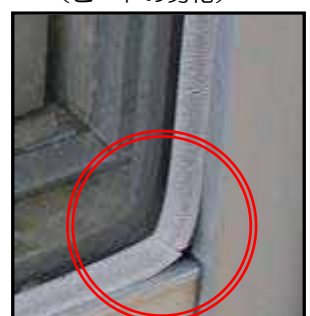
参考(その他のガラス留め) (ビードの劣化)
