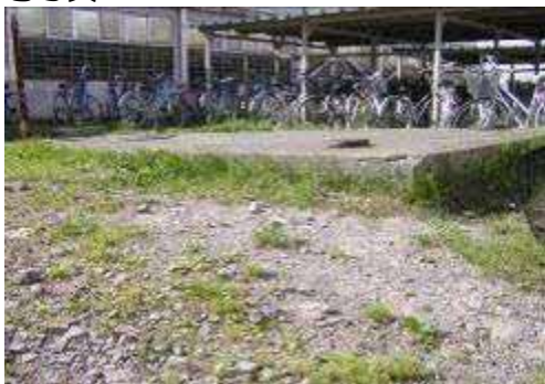
地盤が沈下し、タンクが傾いた例(写真は地下埋設のオイルタンク)
