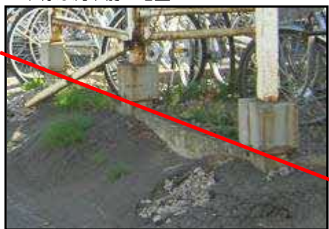
敷地 異常有り (地盤沈下による不陸) ※下線は沈下前の地盤
