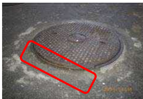
異常あり(マンホール蓋ふちの欠け)
