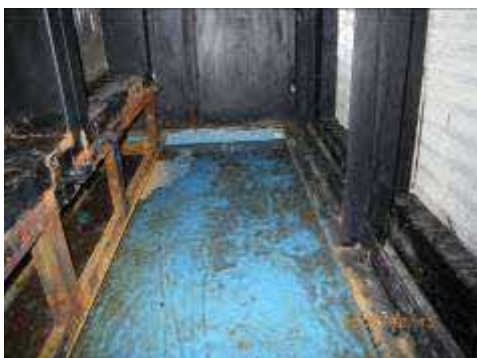
異常あり(ドレンパン及び鋼材に腐食)
