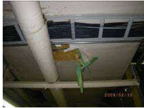
異常あり(保温外装材剥離)
