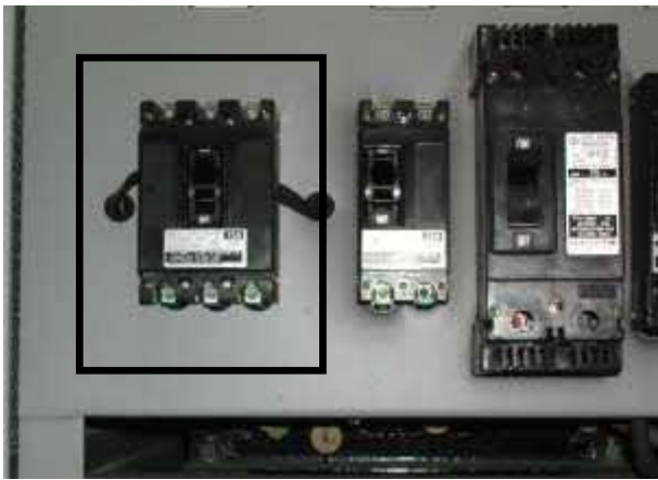
切替装置1 動作用配線用遮断器の例
