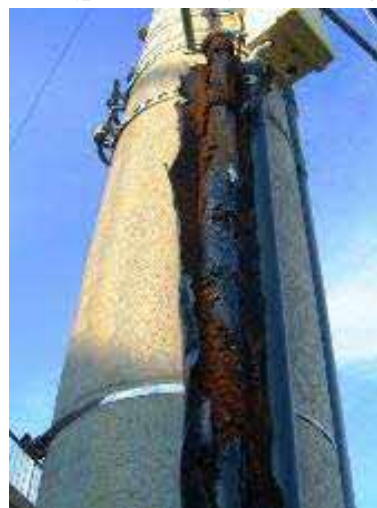
高圧ケーブル類（配管） 異常あり （配管が著しく腐食している。）
