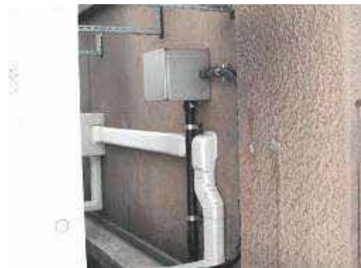
ステンレス製プルボックス （一部もらい錆があるが、異常なし）
