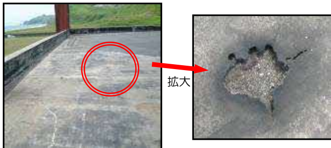
(塗り材の劣化、はがれ)
