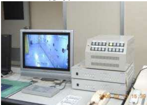
監視カメラ設備 異常なし （モニター）
