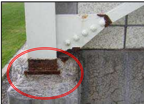
躯体(鉄骨造) 異常有り (コンクリートの欠損)(鉄骨柱脚部の露出)
