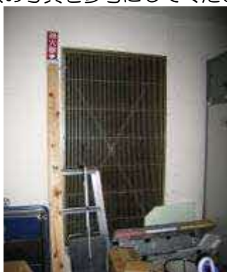
異常あり(排気口がふさがれている)
