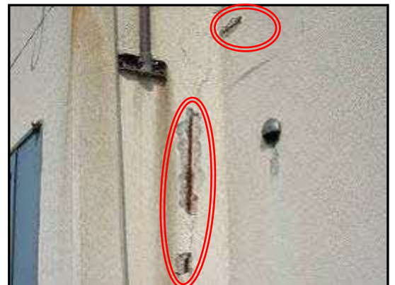
躯体（鉄筋コンクリート造） 異常有り （コンクリート面に鉄筋露出）
