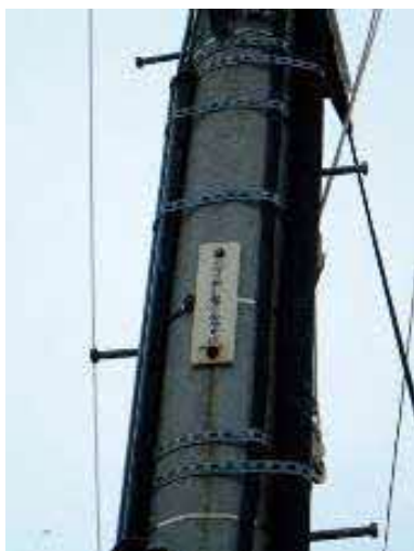
高圧ケーブル類（配管） 異常なし
