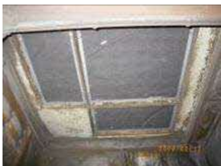
異常あり(空調機フィルター汚れ有り) 参考写真
