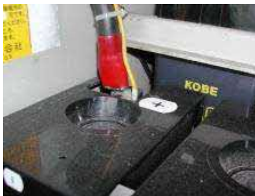
自家発電装置（電気ケーブルの接続状況）
