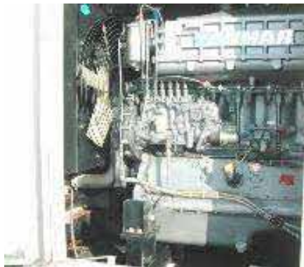
自家発電装置 異常なし
