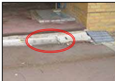
敷地 異常有り (地盤沈下による不陸)
