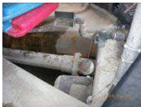
冷却塔内部(ボールタップ)
