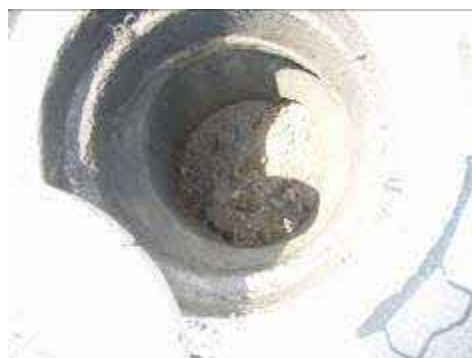
異常あり(雨水枡、土砂堆積)
