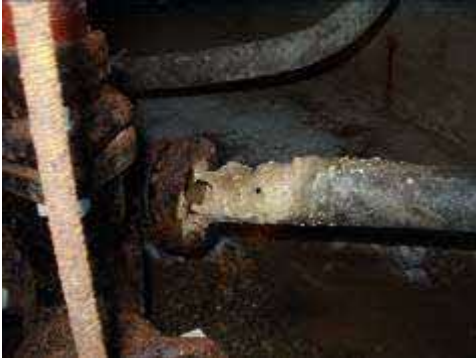
異常あり(ピット内配管腐食)
