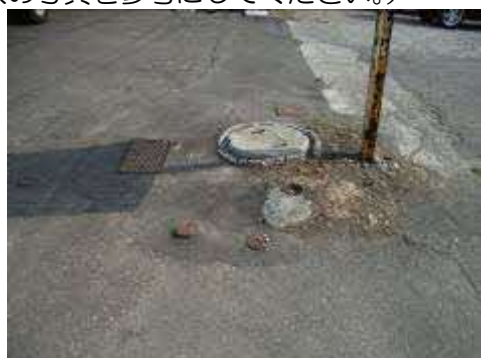
異常あり(枡割れ)
