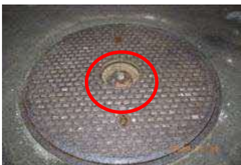
異常あり(マンホール中央蓋欠如)
