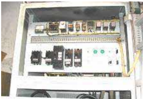
直流電源装置 異常なし(充電器)
