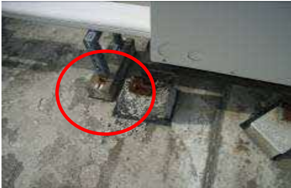
異常あり(アンカーボルト廻りの基礎破損)
