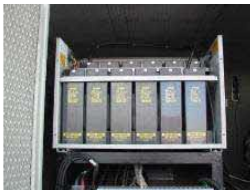
自家発電装置（セル始動用蓄電池）
