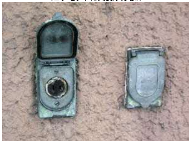
コンセント 異常あり (コンセントに腐食がある。)
