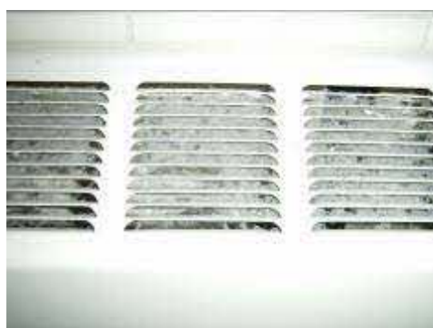
異常あり(吹出口がほこりで詰まっている)
