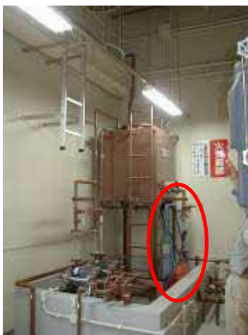
異常あり(防油堤内にもものがある)
