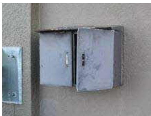
扉に変形があり右扉は閉まりづらく、左扉は開かない。
