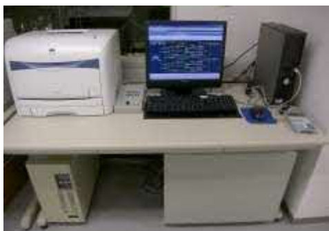
中央監視機器
