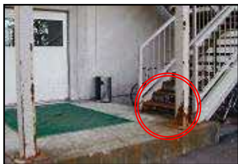
屋外階段等 異常有り (錆の浸食が著しい) (錆落としも併せた、塗装補修が必要)
