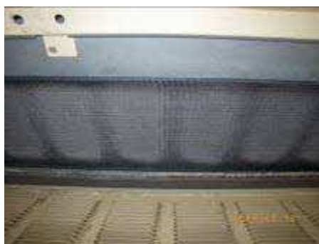
異常あり(放熱器フィルター汚れ有り)
