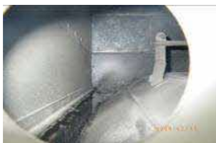
異常あり(羽根が閉まっている)
