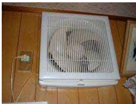
正常な壁換気扇
