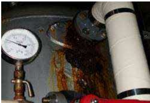
異常あり(溶接部から漏れ)
