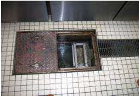
異常なし(清掃後グリストラップ)
