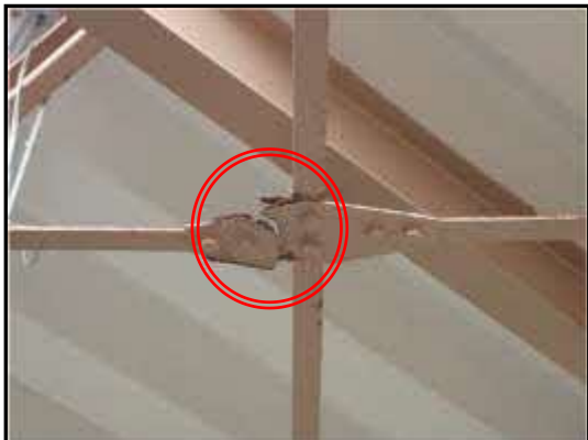
躯体(鉄骨造) 異常有り (鉄骨筋交いの破断)
