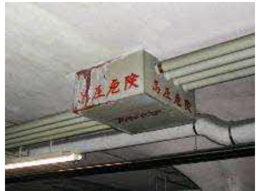
高圧ケーブル類（ボックス） 異常あり （ボックスの腐食が激しい。）
