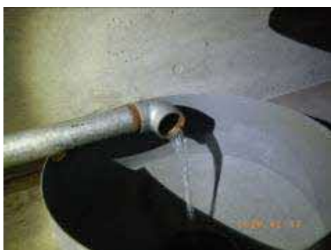
異常あり(水が出ている)
