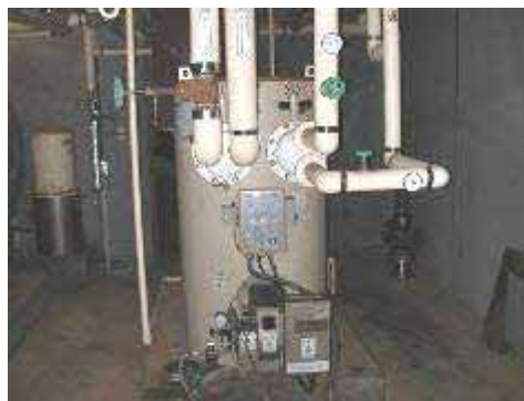
温水器(暖房・給湯兼用)
