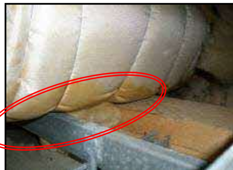
参考 (天井裏の雨漏り箇所の確認) (丸で囲まれた部分に濡れたあとが見える)
