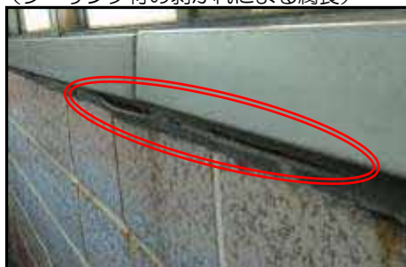
外部建具 異常有り (シーリング材の剥がれによる腐食)
