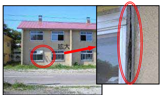
外部建具（窓サッシ等） 異常有り (木下地の腐食、シーリングの劣化)
