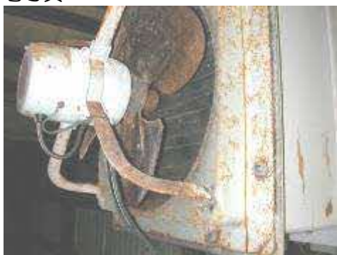
モーター及び羽根が腐食した有圧扇
