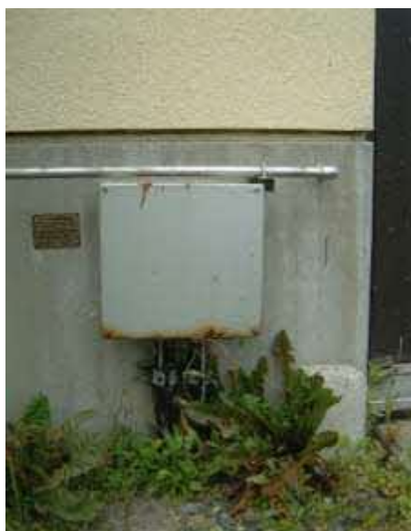
電気露出配管 異常あり (ボックスに腐食がある。)
