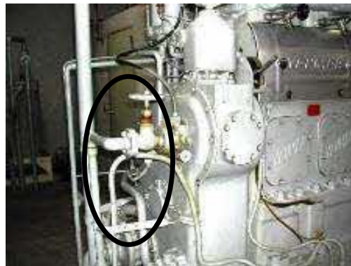
自家発電装置 異常あり (本体から油漏れがある。)
