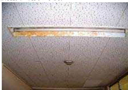
照明器具 異常あり （照明器具に腐食がある。）
