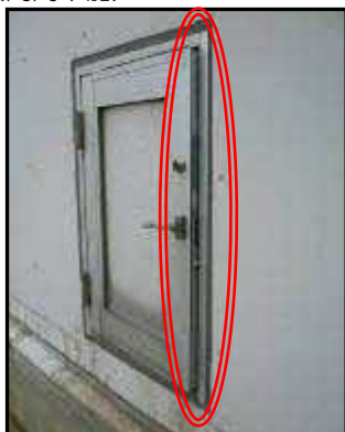
外部点検口 異常有り (開閉不能)
