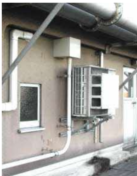
電気露出配管 異常なし
