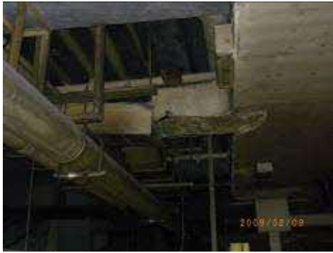
異常あり(保温材剥離)
