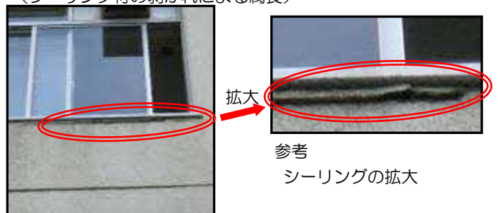
外部建具 異常有り (シーリング材の剥がれによる腐食)
