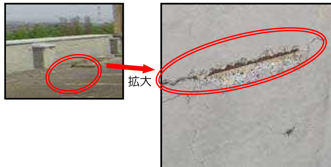
パラペット 異常有り (モルタル剥離)(鉄筋の露出)
