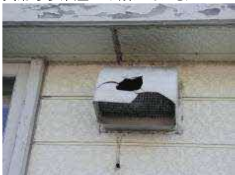
異常あり(フード割れ)
