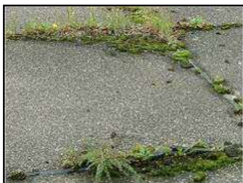
屋上面 異常有り (雑草全面に繁茂)
