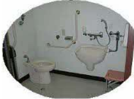
多目的トイレ
