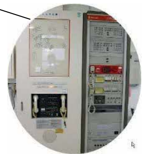
写真右=増幅器、操作装置 (非常放送装置)
