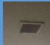
天井設置の換気装置
