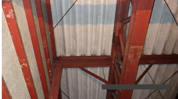
屋根用折板裏石綿断熱材
