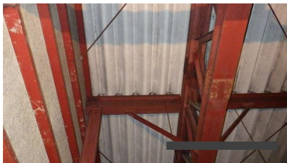
屋根用折板裏石綿断熱材
