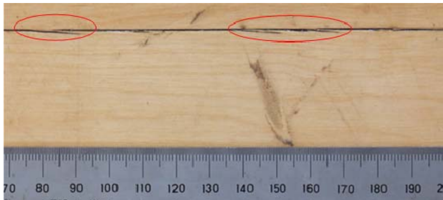
写真1 事例4の現地調査で確認された表面材の裂け (本体育館は事故発生の10か月後に 全面サンダー掛け後の再塗装が施されていた。)
