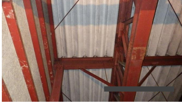
屋根用折板裏石綿断熱材
