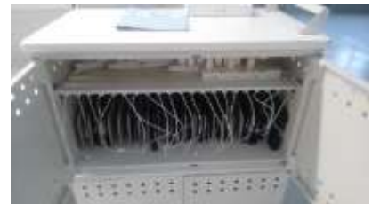
【充電保管庫の設置例】
